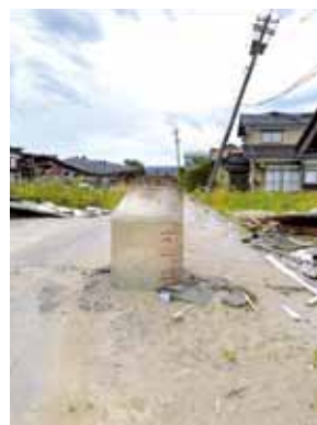
隆起したマンホール
